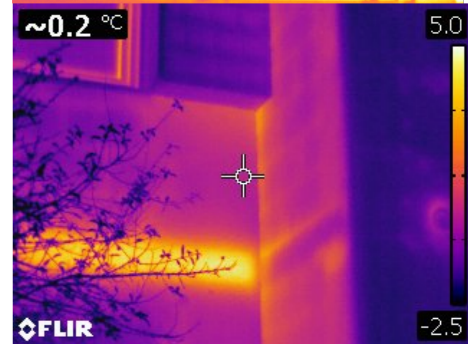
Thermografieaufnahmen haben keinen Bezug zum Beispielhaus und zeigen Schwachstellen anderer Häuser. Quelle: InDiGuD
